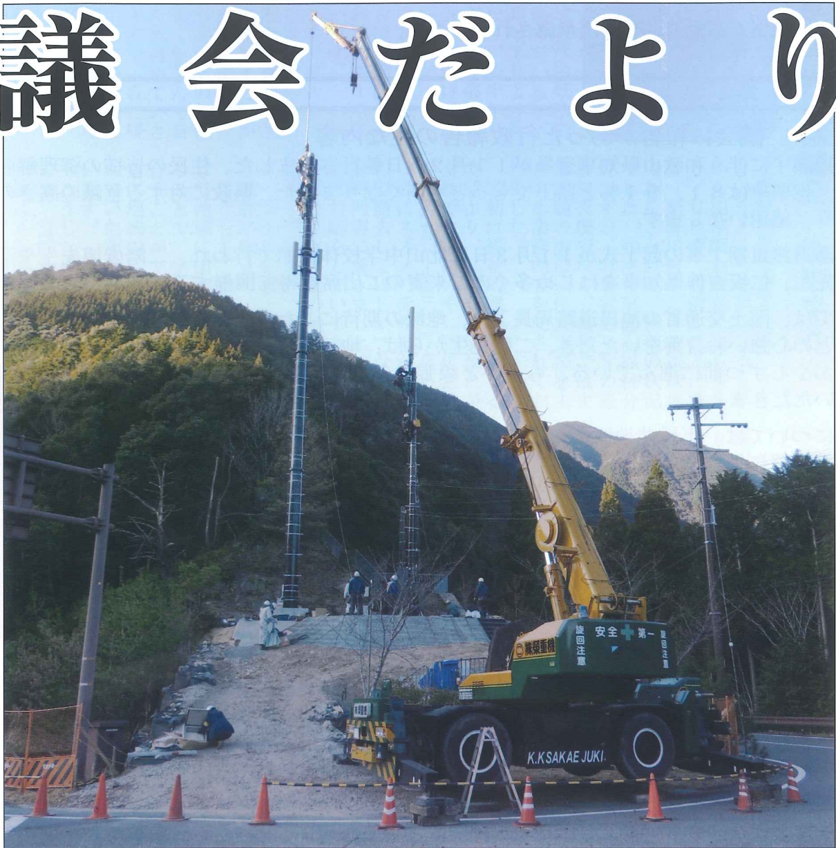
※現在建設中の小松携帯電話エリア整備事業の携帯アンテナ
